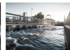
TRATAMIENTO DE AGUAS
