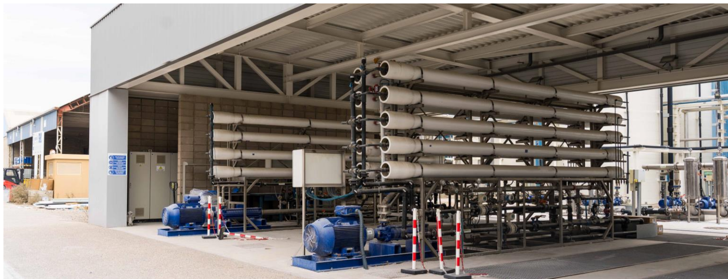
Instalaciones proyecto ZEROSILIBRINE( fase III)
