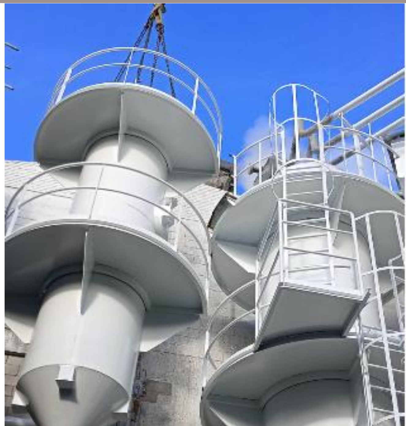
Equipos para la recuperación de calor
